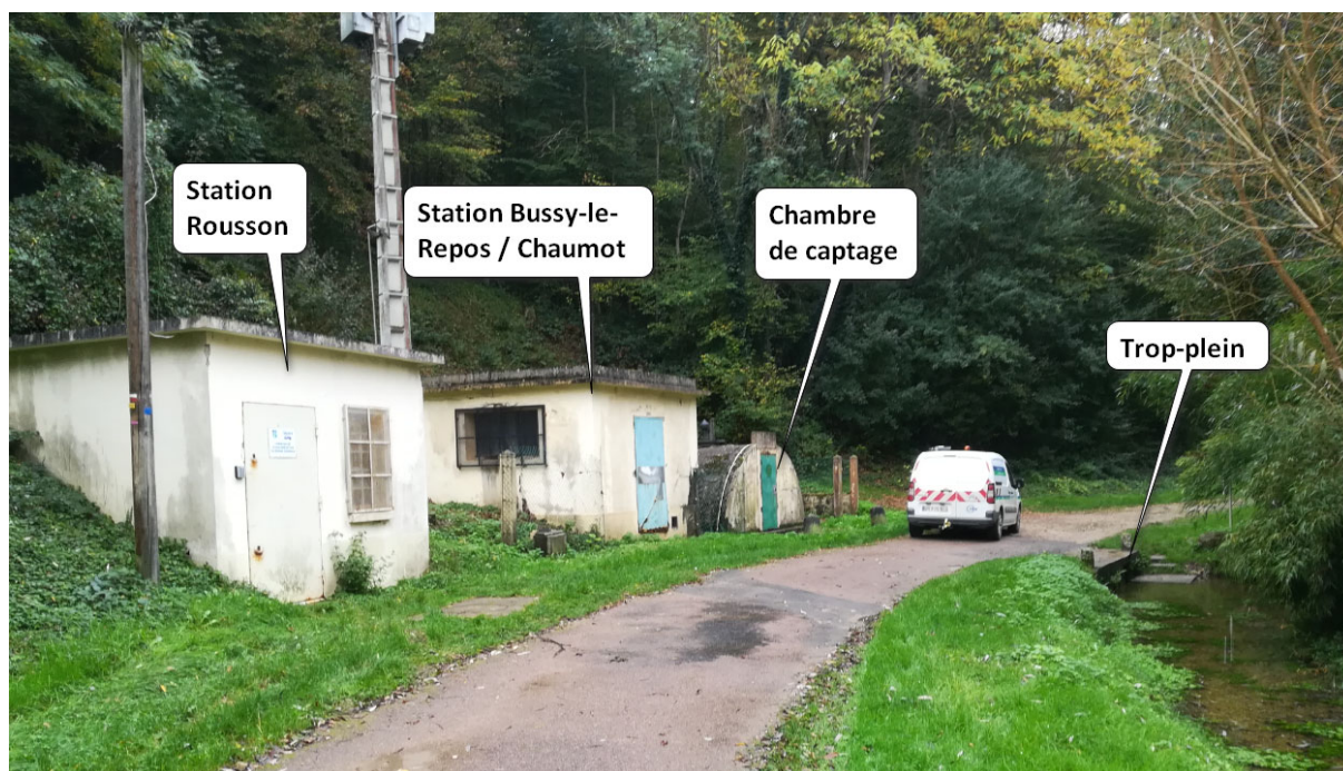
Figure 2 : captage de la source de la Fontaine Rouge.
