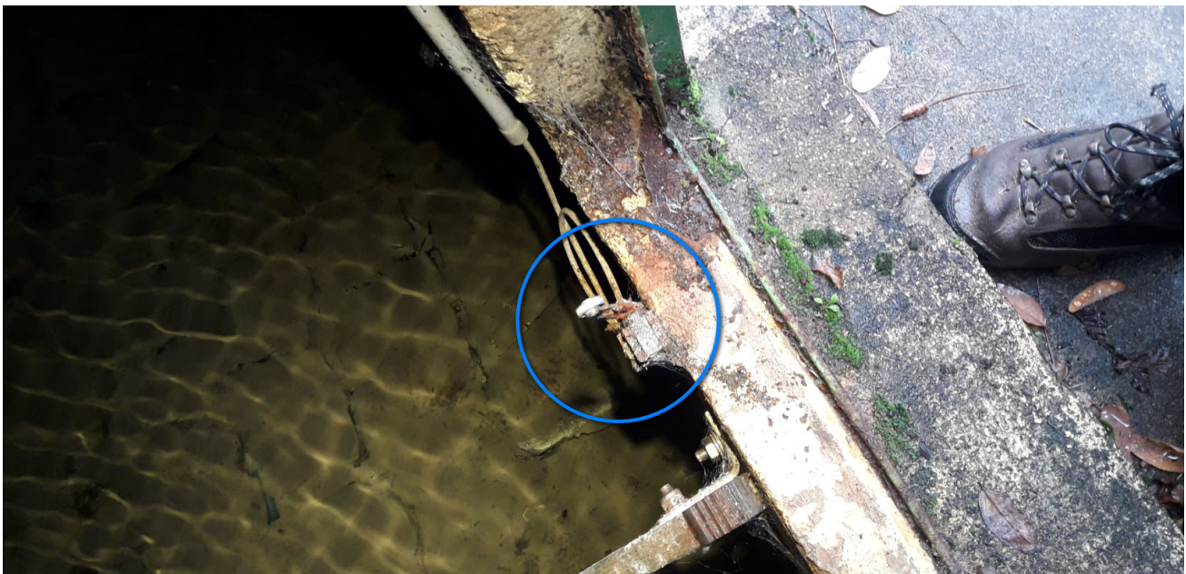
Figure 12 : contacteur bassin de collecte.
